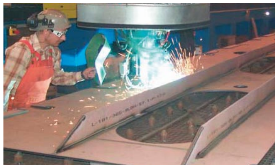
Figur 3. Den flexibla laseranläggningen vid Odensevarvet avsedd för såväl skärning som svetsning. Utrustningen togs i drift redan 1997 och inkluderar bl.a. en 12 kW CO 2 -laser.
