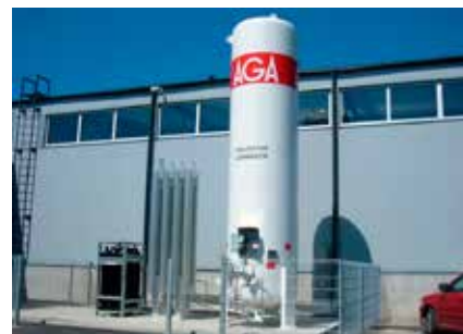
Bild 5. Tankstation för flytande nitrogen. Till vänster om tanken står en förångare för att omvandla den flytande gasen till gasfas, hela installationen placerad på en betongplatta.
