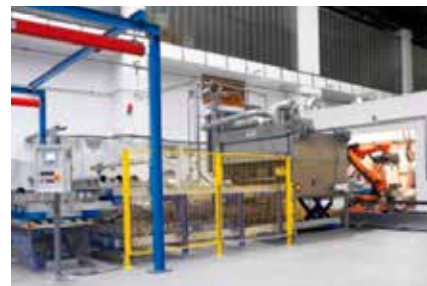
Figur 12. Helautomatisk hybridsvetsanläggning för tillverkning av hydraulikcylindrar installerad hos F.X. Meiller i München.
