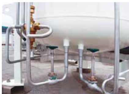
Bild 4. Internförångare (trycktillsats) placerad under tanken. Till vänster syns också den s.k PER-regulatorn som reglerar trycket.
