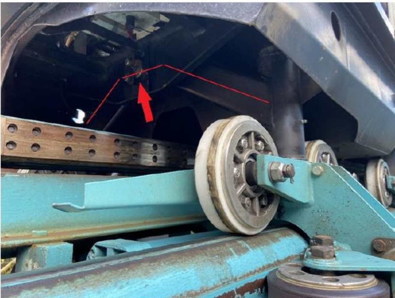
Figur 3. Undersidan på den främsta vagnen i ett av tågen med den främre rörliga bärarmen markerad med rött streck. Den röda pilen pekar mot änden på den axel där bärarmen var monterad. (Bilden är inte från olyckståget).
